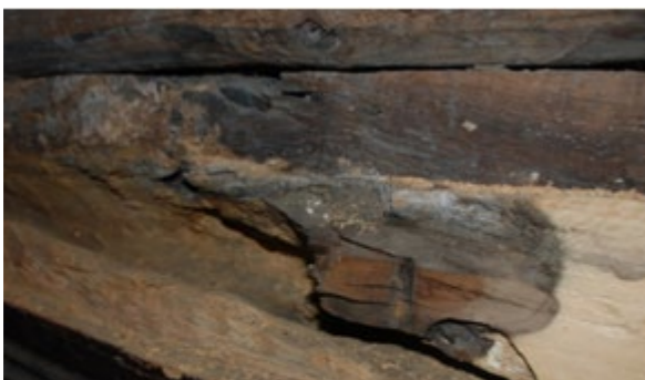
图 8 开裂、虫蛀的大梁
