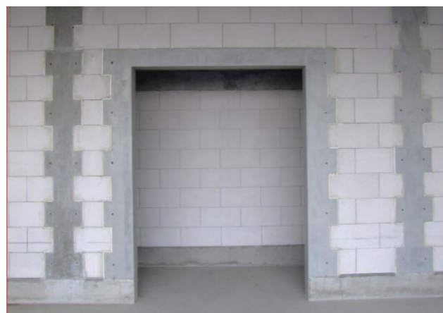
砌体横平竖直、灰缝大小均匀、墙面颜色一致、顶砖砂浆饱满、斜度一致、构造柱留槎标准
